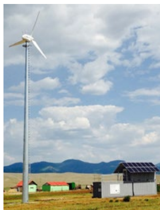
Abb. 1: Autarke Wind-PV-Hybridanlage – Ausbildungsstätte der MULS in Nart Täw, Mongolei
