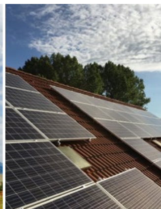
Abb. 2: PV-Anlage für das WINNER-Mieterstromprojekt Alfons-Pech-Straße 18-24, Chemnitz
