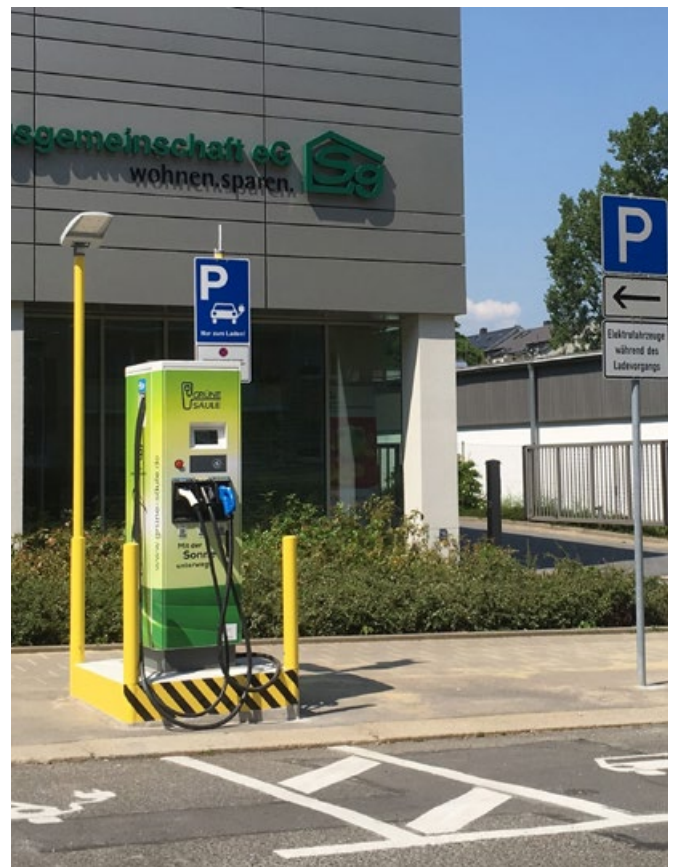
Abb. 7: Öffentliche Schnellladestation vor dem Geschäftsgebäude der CSg
